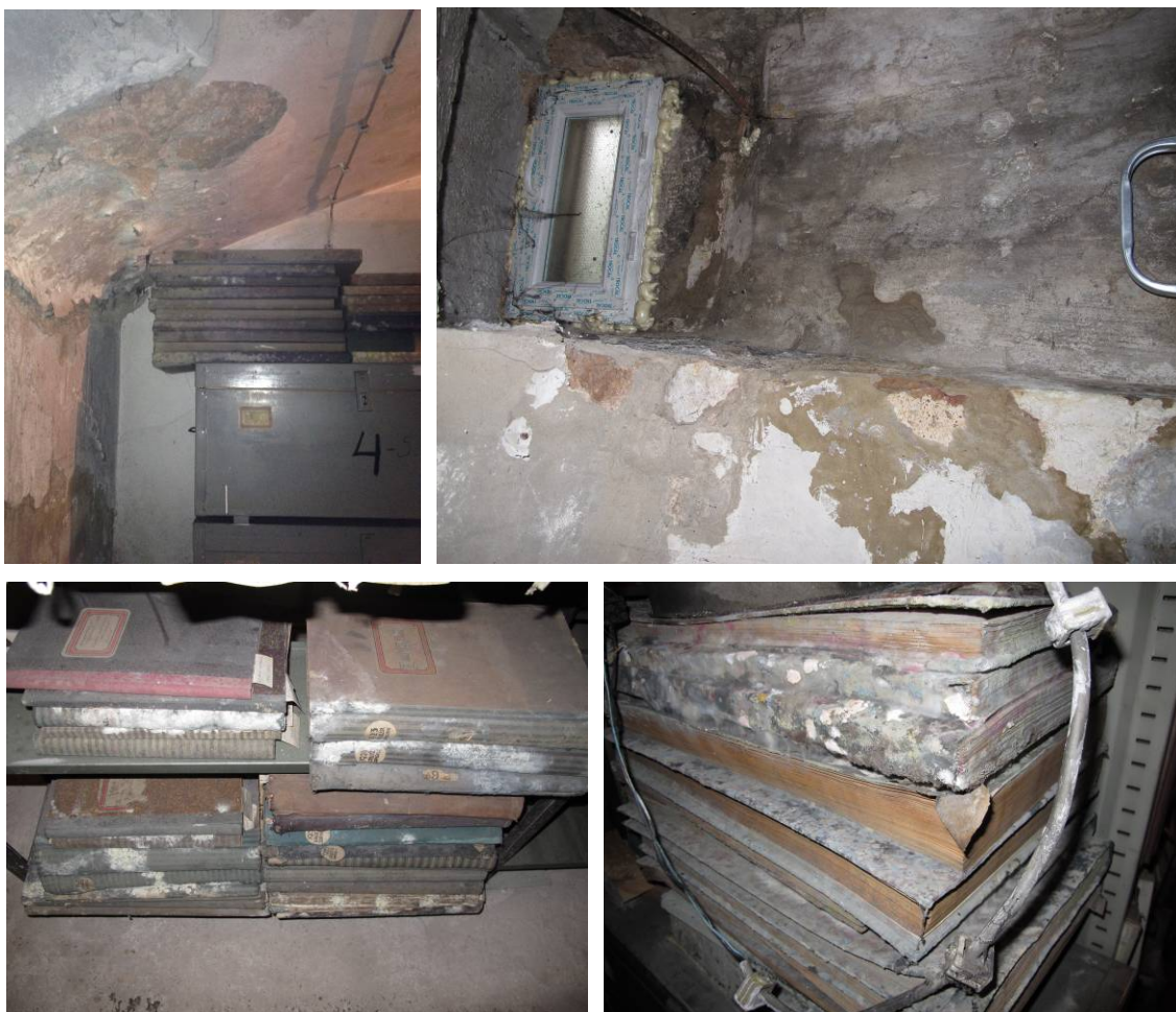
Obr. 4 Vlhké stěny suterénních depozitářů (nahore) a plísni poškozené knihy tamtéž (dole)
